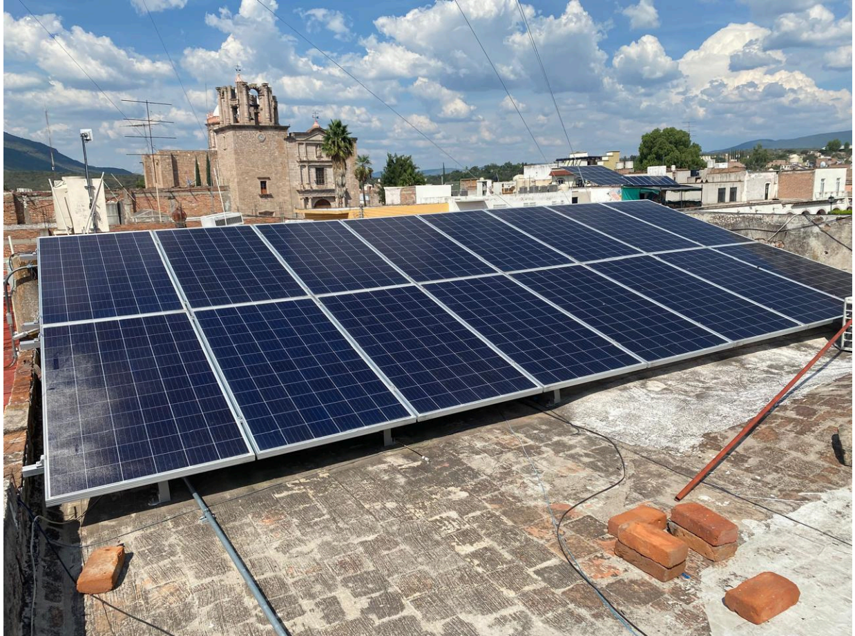
Paneles fotovoltaicos instalados en el municipio de Santa María de los Ángeles, Jalisco, a través del financiamiento para acción climática con la JINOR.
